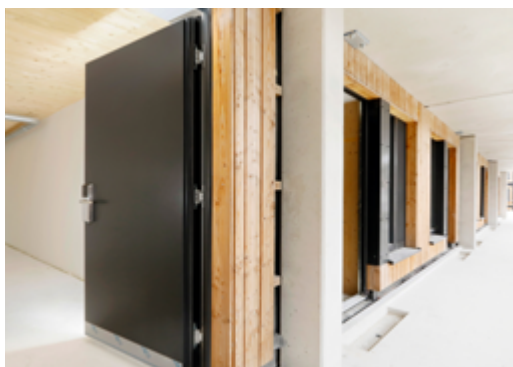
Bei der Bändertechnik legte das Holzbauunternehmen Huber & Sohn Wert auf die Verbindung aus Ästhetik und Stabilität und entschied sich für Dynamic 3D-20 von SFS.
